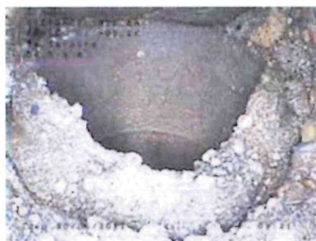
Raccordement défectueux avec fissures
